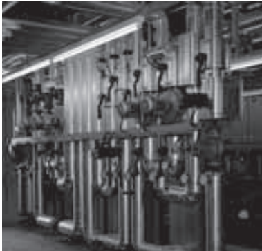
Steuerung einer Pumpenstation mit ATV 12
